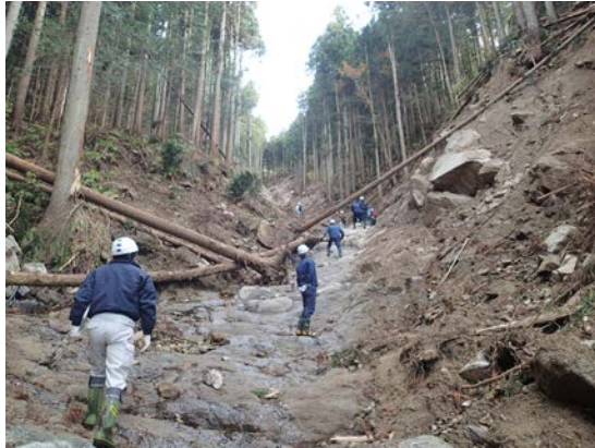
(流下区域の溪床の露岩と侵食状況)
