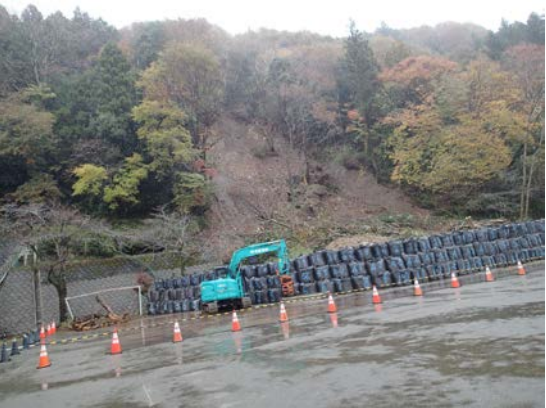
(校庭への土砂流出状況)
